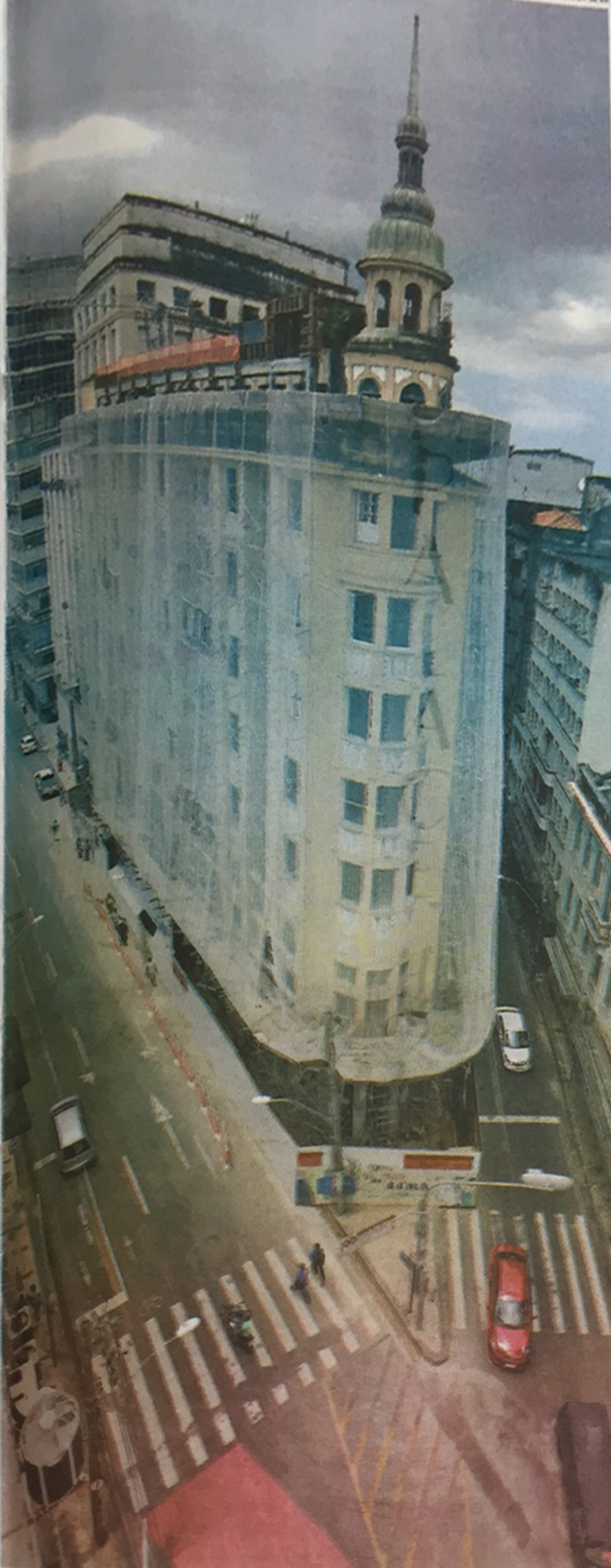
Edifício de 1934, com fachada em art déco, divide as ruas Chile, da Ajuda e do Tesouro. Grupo mineiro à frente da reforma prevê reinauguração para junho do ano que vem
